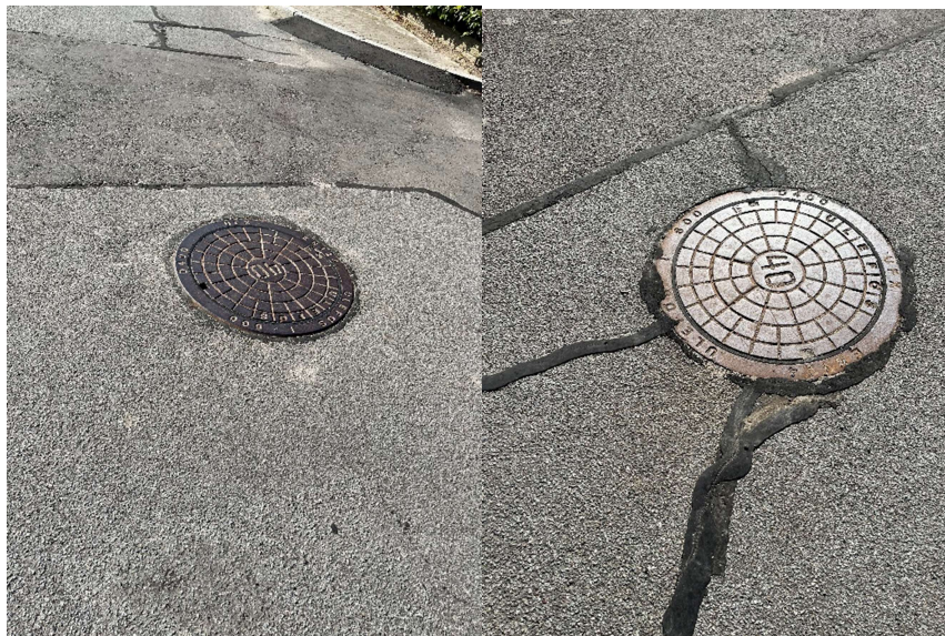
Figur 4.3.3 Eksempel på brønd der ligger for tæt på ledningsgrav: Regnersvej nr. 33-67.
