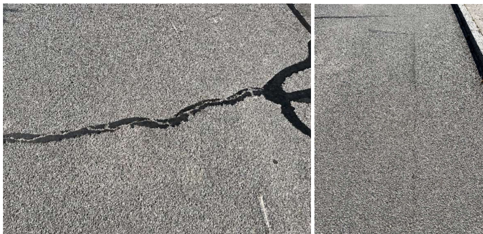
Figur 4.3.1 Eksempel på tværgående (th) og langsgående (tv) revne.
