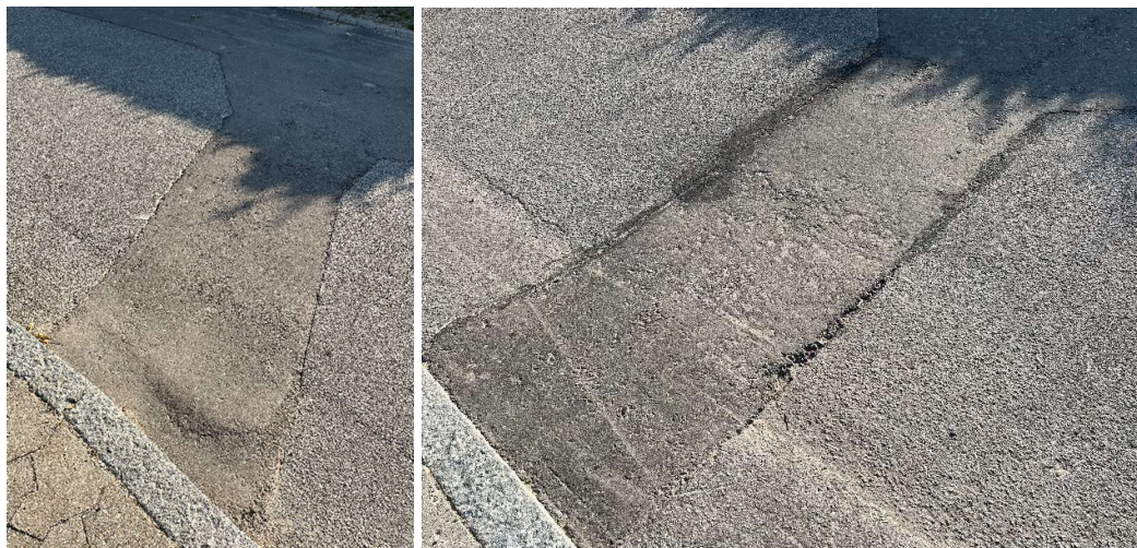
Figur 4.3.2 Eksempel på revner i samlinger omkring ledningsgrave:
